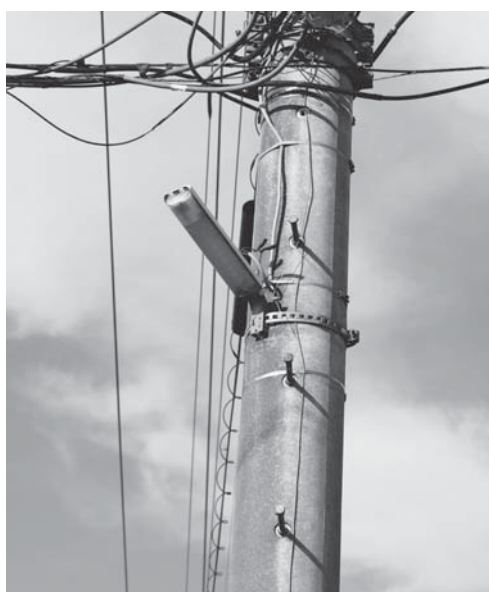
LEDに交換された防犯灯
