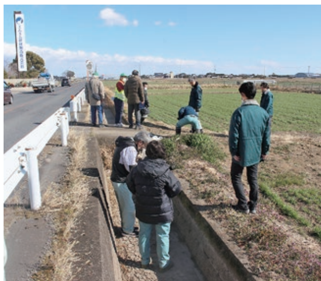
広域農道脇用水路の劣化を確認
