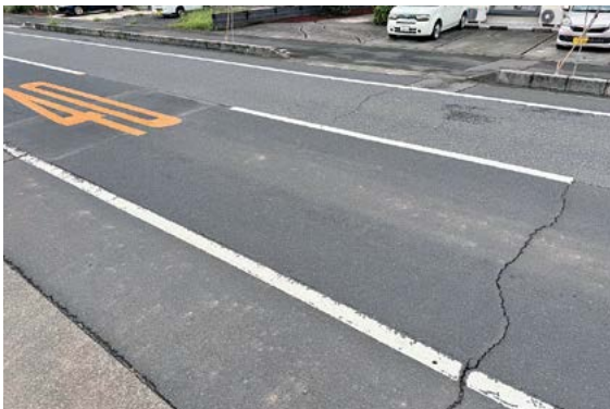
傷んでいる舗装
