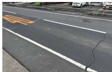
舗装にヒビの入った町道
