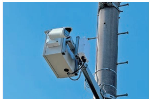
新たに設置した防犯カメラ
