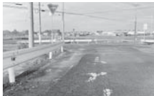
消えかかった止まれの道路標示
