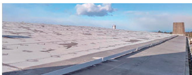
強風により防水シートが破損した大屋根
