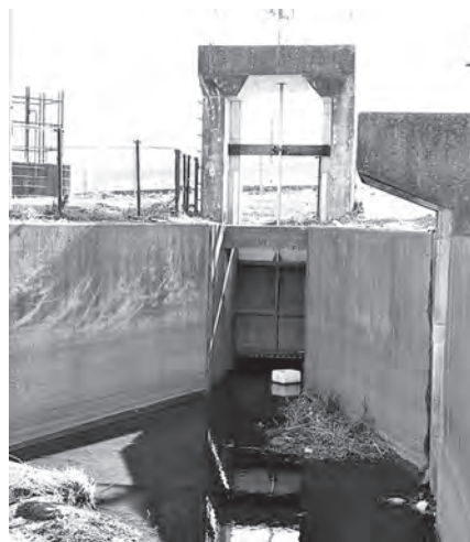
越水被害のあった中島地区の水門
